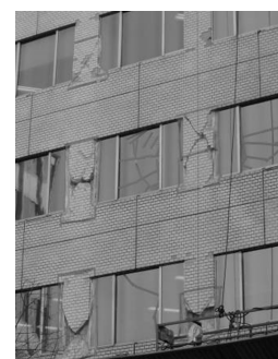
▲地震による外壁・窓ガラスの破損
