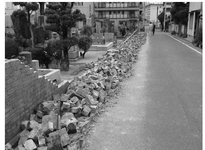
▲地震によるブロック塀の倒壊
