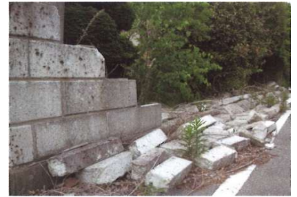
倒壊したブロック塀
