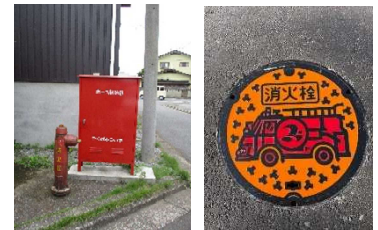
地上式・地下式消火栓
