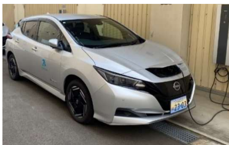
伊奈庁舎電気自動車及び充電設備
