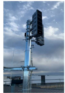
防災行政無線屋外スピーカー
