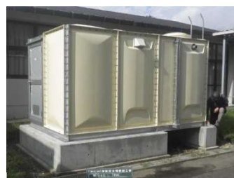
老朽化により更新した受水槽
