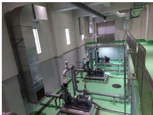
みらい平配水場配水ポンプ室
