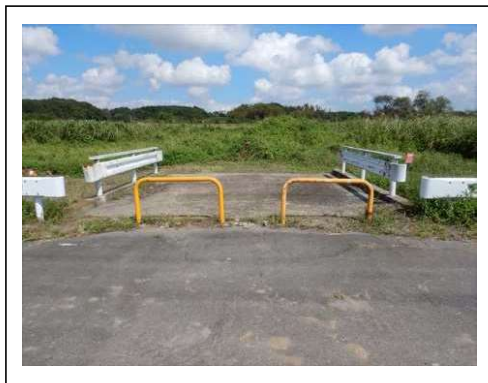
写真 5.2 橋梁の先に道路が接続されていない事例
