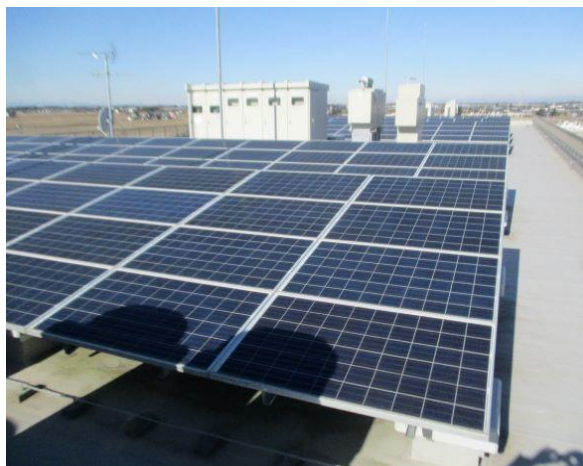
<太陽光発電設備>
