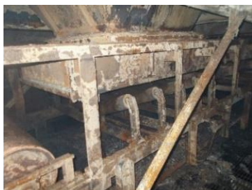
▲火災で焼損した設備
