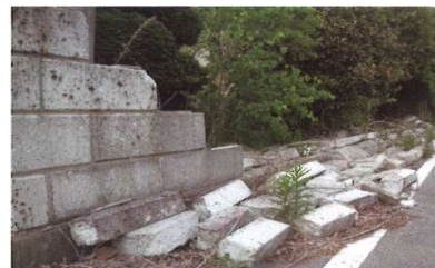
倒壊したブロック塀
