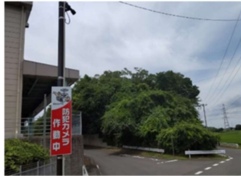
新設した監視カメラ（筒戸）
