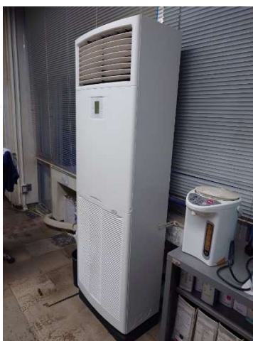
谷和原庁舎 1F 空調設備（3 台設置）
