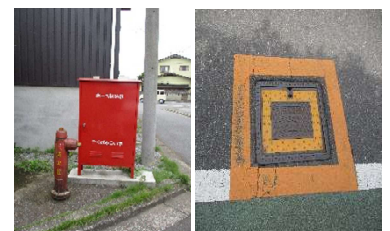
地上式・地下式消火栓
