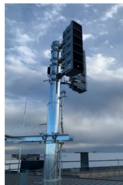
防災行政無線屋外スピーカー
