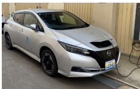
伊奈庁舎電気自動車及び充電設備
