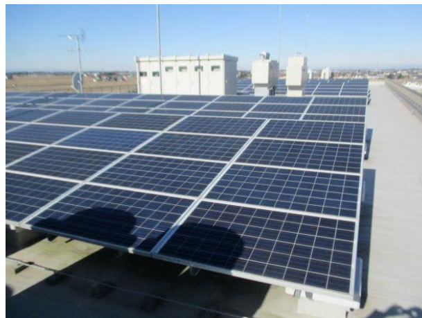
<太陽光発電設備>
