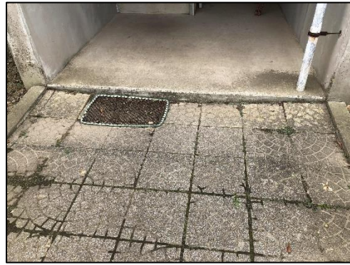
エントランス部分の段差
