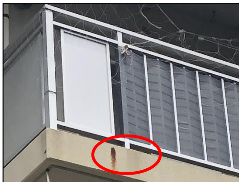
外壁に鉄筋露出
