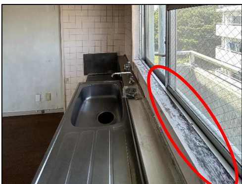
住戸内 台所木製窓台劣化
