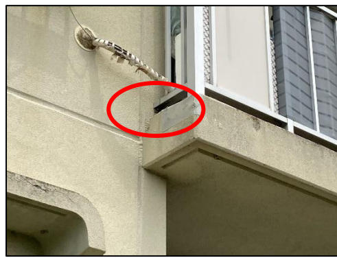
バルコニー側面外壁破損(応急処置済み)
