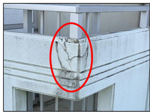
バルコニー手すり部クラック発生
