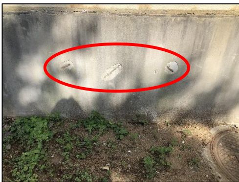
外壁に鉄筋露出
