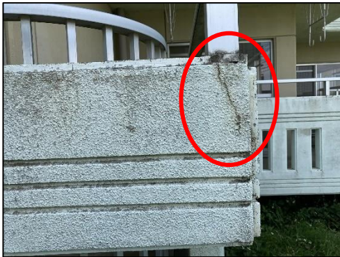
バルコニー手すり部モルタル破損
