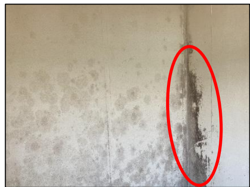
住戸内 壁面の一部に結露カビ発生
