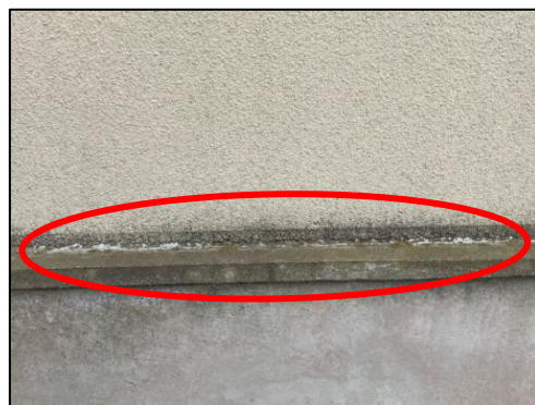
外壁目地シール材の劣化
