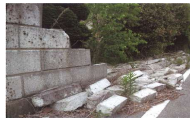
倒壊したブロック塀
