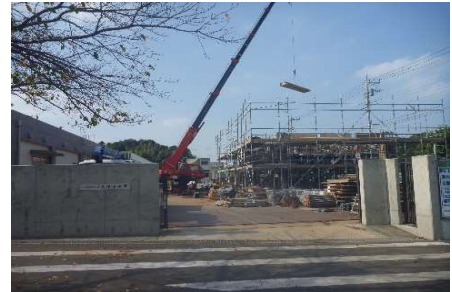
久保浄水場低区配水施設
