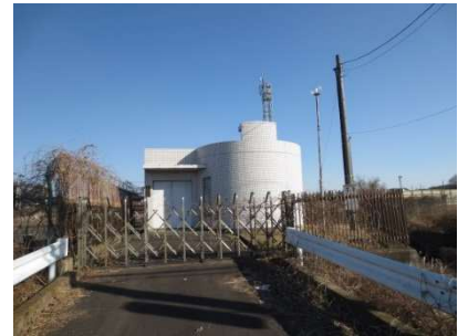
高掛中継ポンプ場
