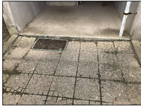
エントランス部分の段差
