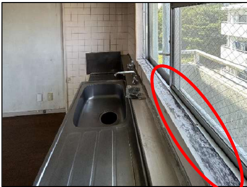
住戸内 台所木製窓台劣化
