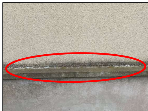
外壁目地シール材の劣化
