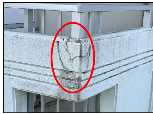
バルコニー手すり部クラック発生
