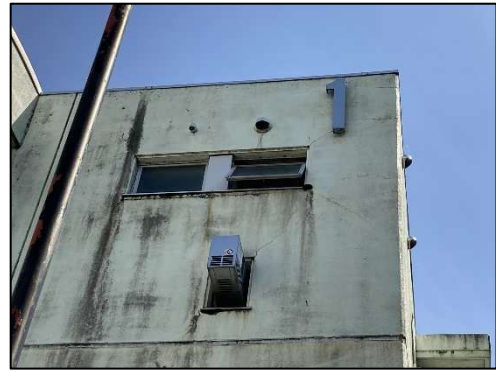
外壁に黒染み・クラック発生
