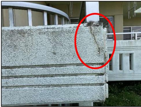
バルコニー手すり部モルタル破損
