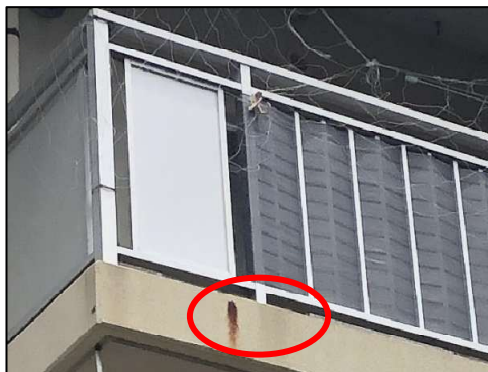
外壁に鉄筋露出
