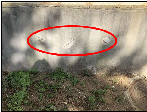
外壁に鉄筋露出
