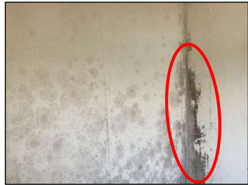
住戸内 壁面の一部に結露カビ発生
