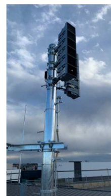
防災行政無線屋外スピーカー
