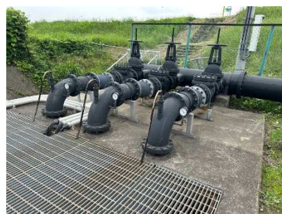
排水機場及び樋管管理事業
