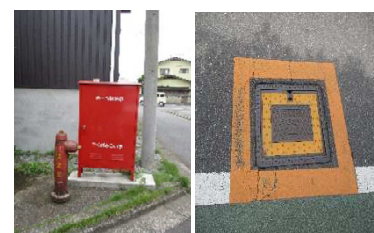
地上式・地下式消火栓
