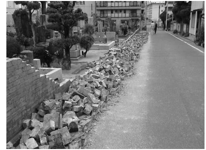
▲地震によるブロック塀の倒壊
