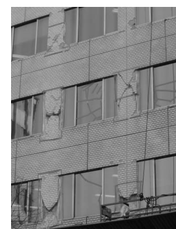
▲地震による外壁・窓ガラスの破損
