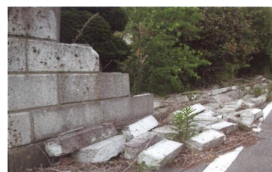
倒壊したブロック塀等
