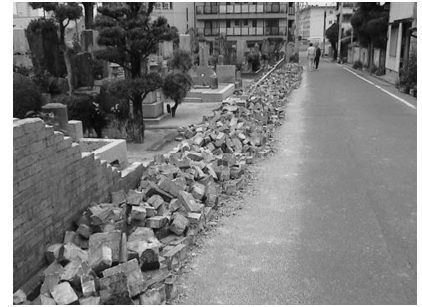
▲地震によるブロック塀の倒壊
