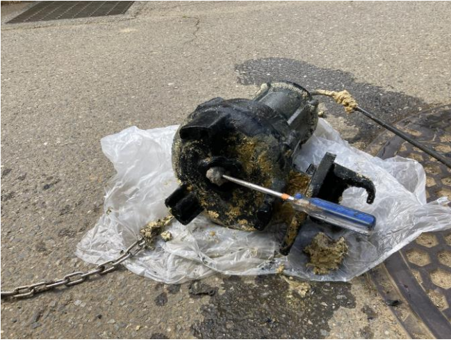
写真1 異物（タオル）流入による詰まり発生状況
