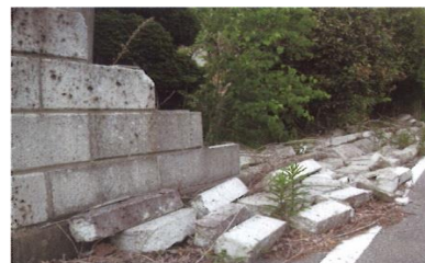
倒壊したブロック塀等
