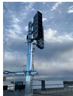
防災行政無線屋外スピーカー
