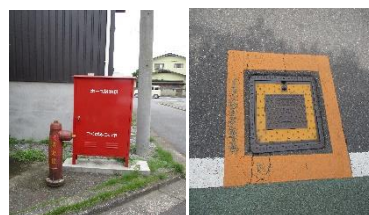
地上式・地下式消火栓
