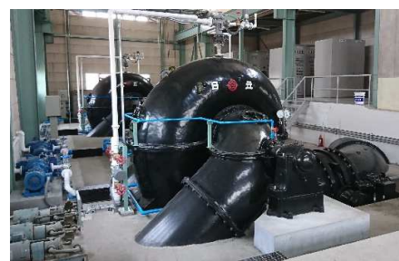
本田排水機場 2 号機ポンプ
