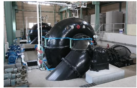
本田排水機場 2 号機ポンプ
