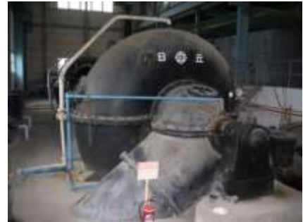
本田排水機場 2号機ポンプ
