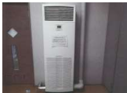
会議室等空調機
