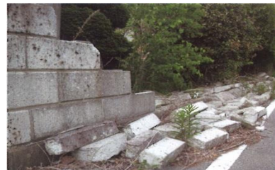
倒壊したブロック塀
