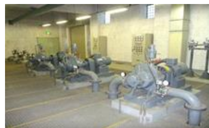
谷和原浄水場の配水ポンプ施設
