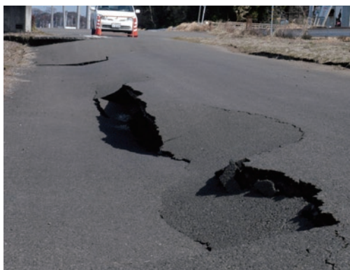
地震により道路は断裂し通行が困難になった
