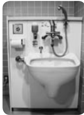
新たに設置された オストメイト対応トイレ
