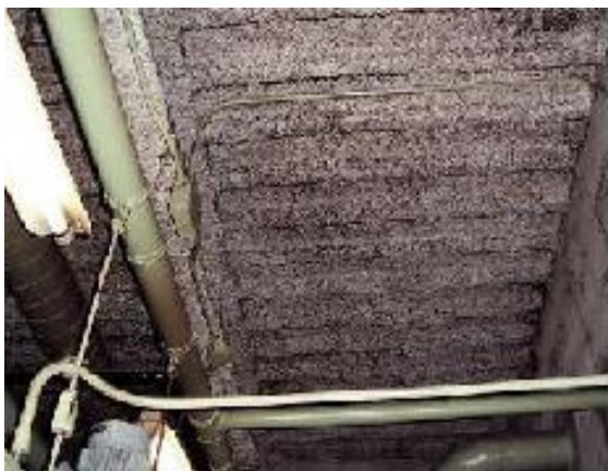
石綿含有吹付けロックウール
