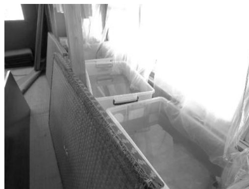
2階：和室漏水の応急措置の状況② (窓際に設置したプラスチック容器に水が溜まる状況)
