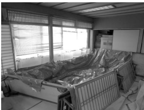
2階：和室漏水の応急措置の状況①
