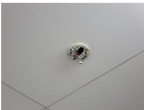
1階：廊下天井漏水の状況② (漏水により火災報知機が破損し落下)
