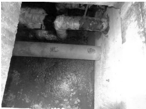
地下：蒸気配水管腐食の状況
