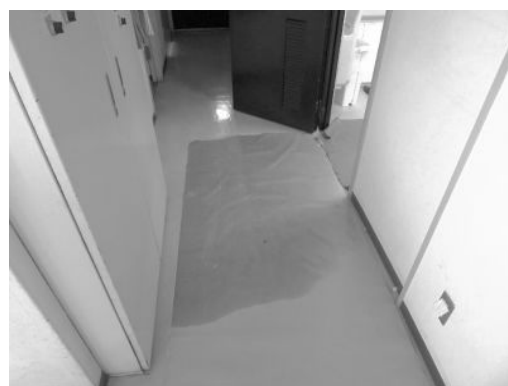
1階：漏水による床浸水の状況
