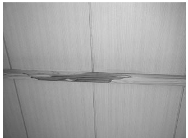
漏水による天井の状況
