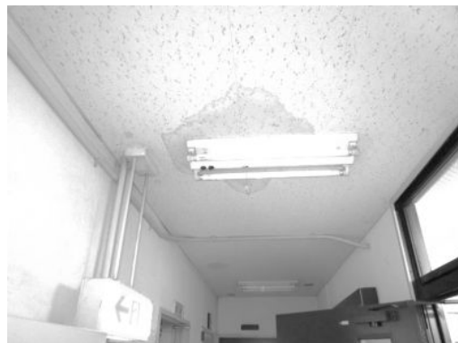
1階：廊下天井漏水の状況①
