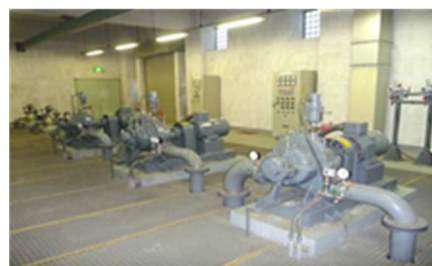
谷和原浄水場の配水ポンプ施設
