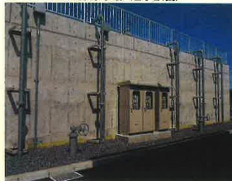
《完成》 (久保浄水場 送水設備)
